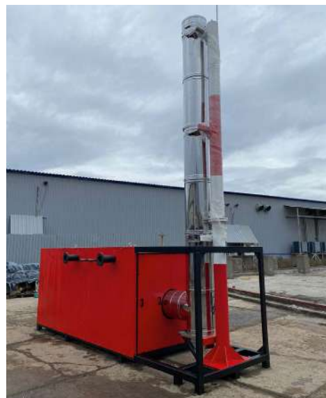
г. Улан-Удэ. Удагаз. Котел наружного размещения 1MBT
