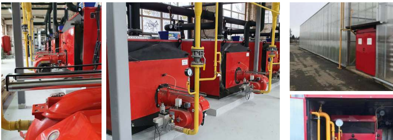
МУП Теплоэнерго. г. Азов. котлы V 1300 КВТ
