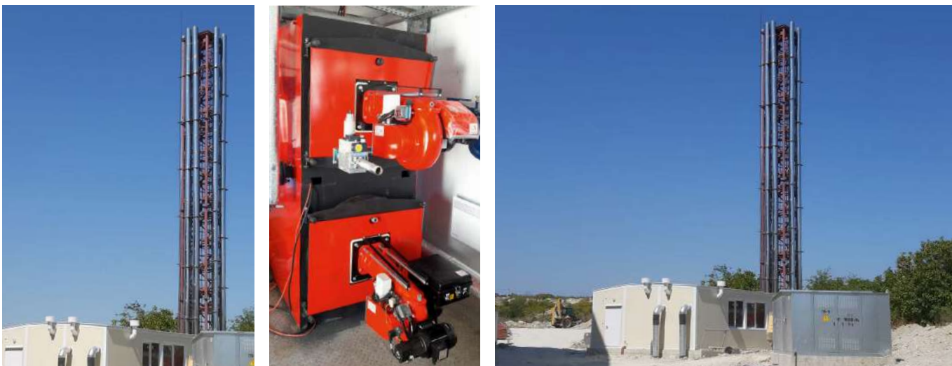
ЖК «Надежда». Блочно-модульная котельная, мощность 3,6 мВт. П. Мысхако, Краснодарский край.
