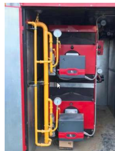
СПК «Колхоз Родина» (Ставропольский край) Котел наружного размещения Wyberg WS 200/200 ( 400 кВт)
