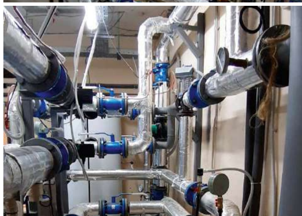
Индивидуальный тепловой пункт. Мощность 600кВт. х. Калинина.
