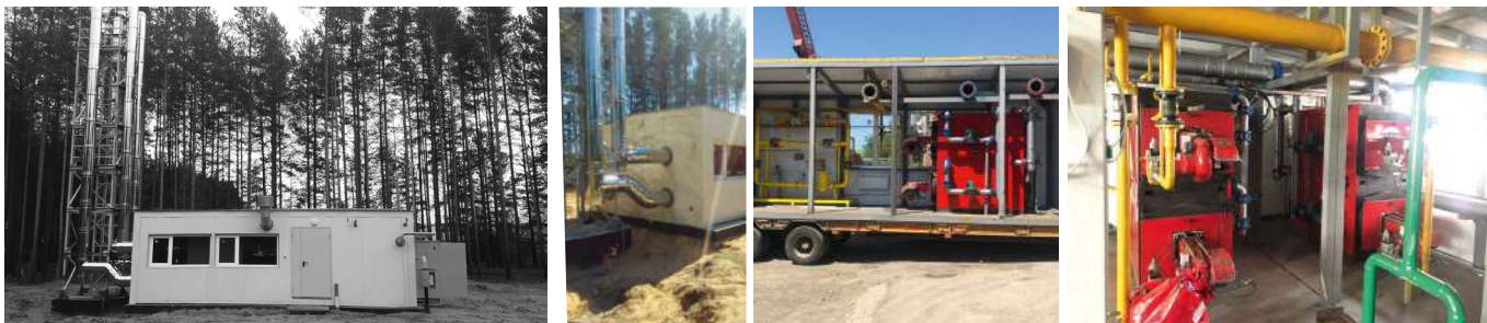
Гостинично-торговый комплекс. Котельная блочно-модульная WYBERG 2.4мВт. г. Луга
