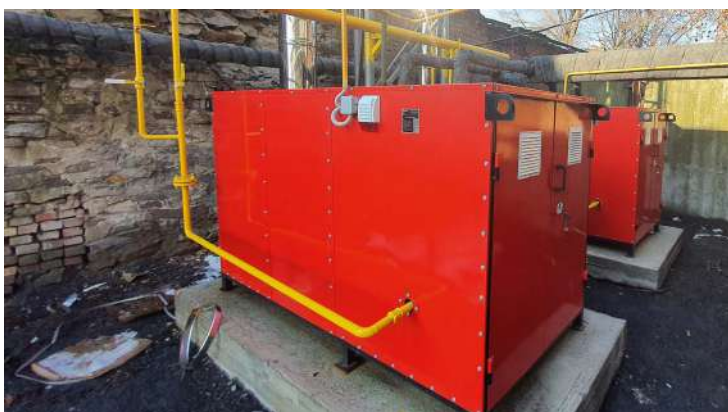
ГК СТИЛ г. Шахты, Ростовская область. Котлы наружного размещения VS 700,800,1300
